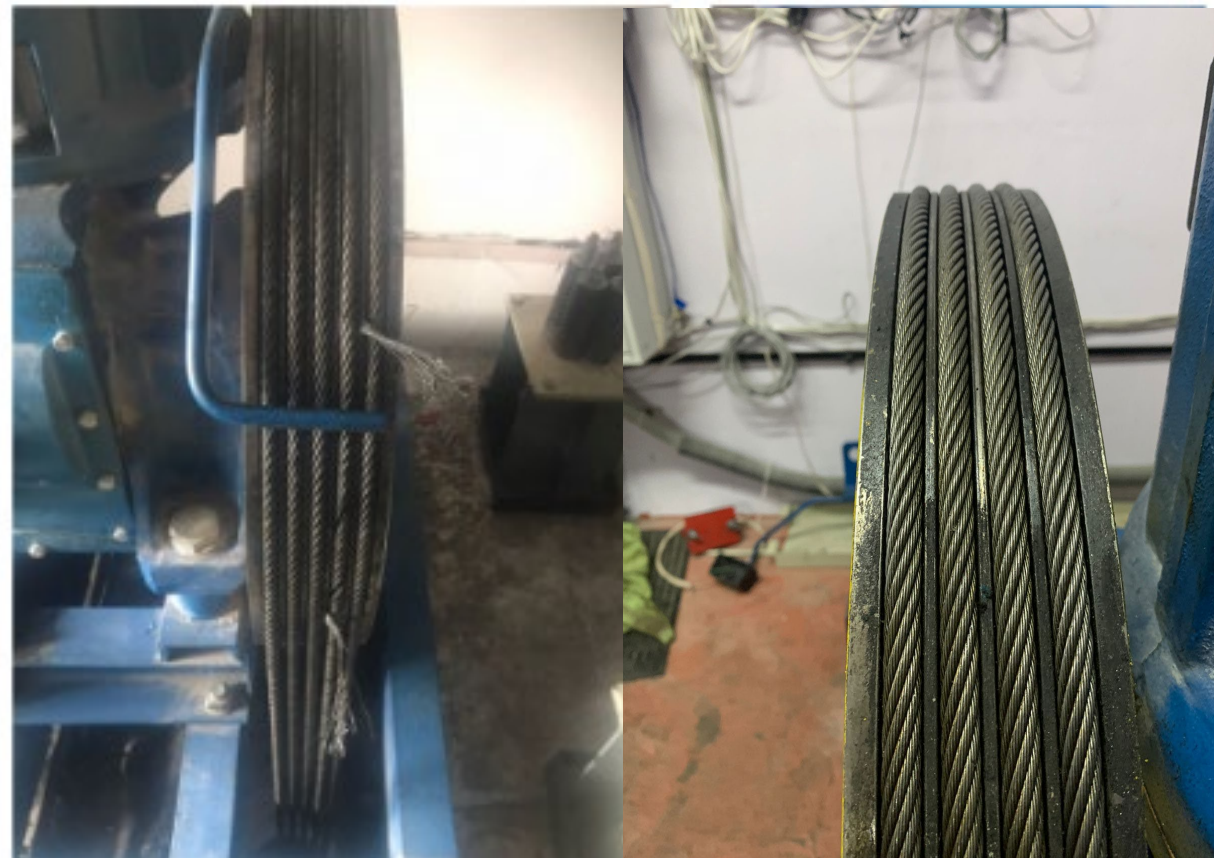
Тяговые канаты до ремонта
